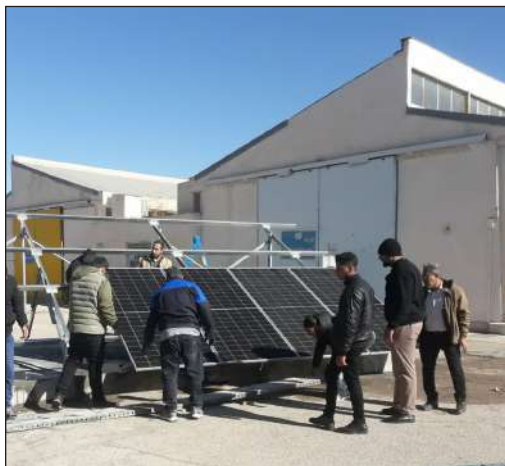
▼ بهسازی و تجهیز کارگاه انرژی خورشیدی مجتمع مراکز کرمان از محل منابع ساتبا
